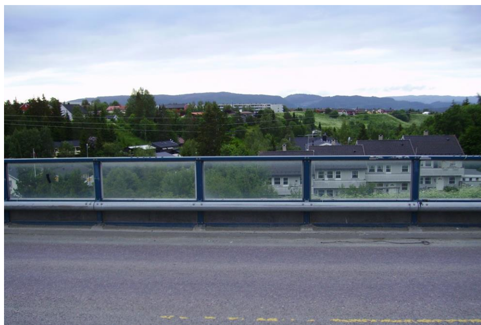
Figur 19: Innglassede skjermer skal registreres som støyskjerm.
